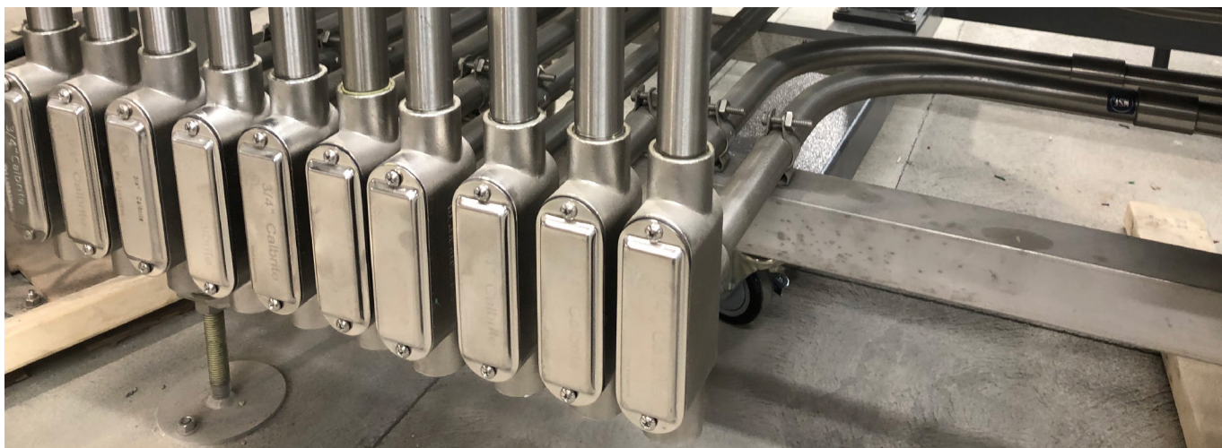
NEC-compliant rigid conduit installation
